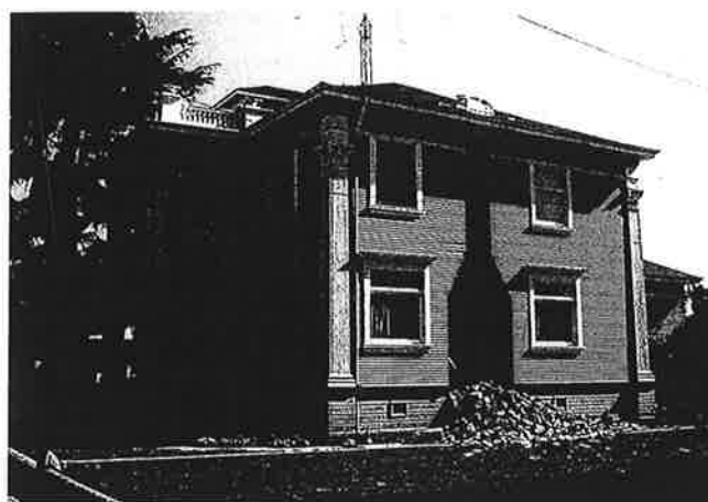
c) effondrement d'une cheminée lors du séisme de Loma Prieta (Californie), 1989
